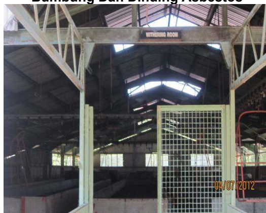
Gambar 6.6 Kilang Masih Menggunakan Bumbung Dan Dinding Asbestos
