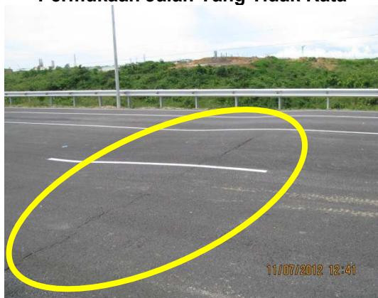
Gambar 2.9 Permukaan Jalan Yang Tidak Rata
