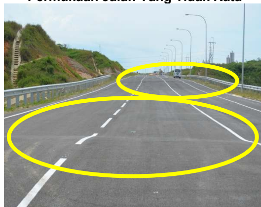
Gambar 2.10 Permukaan Jalan Yang Tidak Rata
