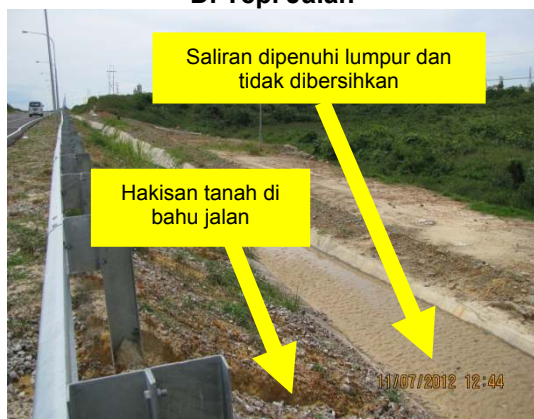
Gambar 2.13 Hakisan Tanah Memasuki Parit Di Tepi Jalan
