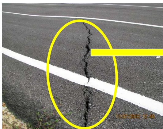
Gambar 2.11 Keretakan Pada Permukaan Jalan
