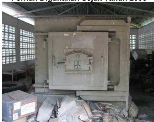
Gambar 3.32 Insinerator Yang Tidak Siap Dan Tidak Pernah Digunakan Sejak Tahun 2003
