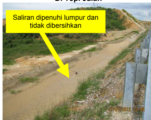
Gambar 2.14 Hakisan Tanah Memasuki Parit Di Tepi Jalan
